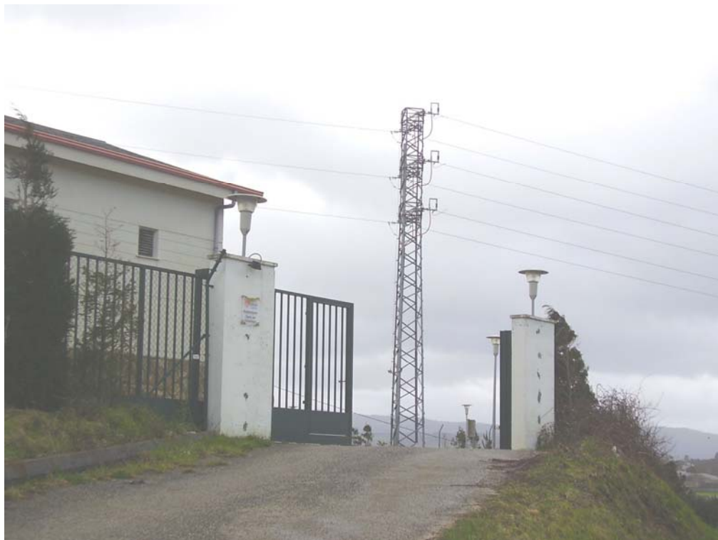
Ilustración 21.- Subestación eléctrica de Tapia de Casariego.
